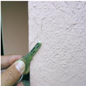
Formation de fissures sur la surface peinte de la façade, en partie jusqu'à la colle en dispersion. Les fissures n'apparaissent qu'au bout de 1 à 3 ans.
