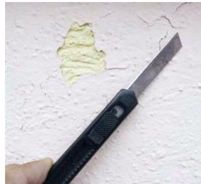
Décollement des couches de peinture et de crépi, parfois jusqu'à la colle en dispersion. Les éclatements n'apparaissent qu'au bout de 1 à 3 ans.
