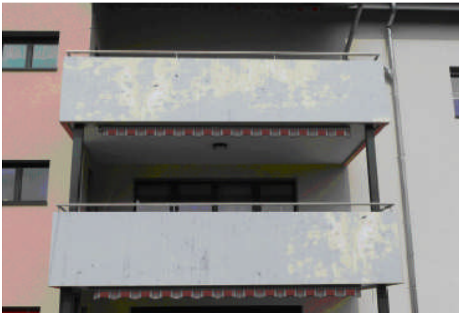
Eléments préfabriqués en béton avec revêtement de peinture pour façades. Efflorescences dans la zone des fissures.
