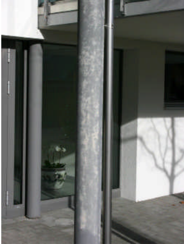
Piliers de béton préfabriqués qui ont été enduits aussitôt après la livraison, sans évaluation du support.
