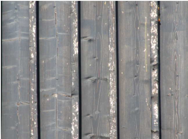
Holzschalung mit typischem Wespenfrass.
