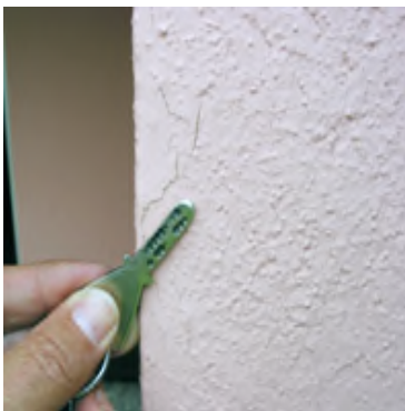
Rissbildungen in der gestrichenen Fassadenfläche, teilweise durchgehend bis zum Gewebekleber. Risse treten erst nach 1-3 Jahren auf.
