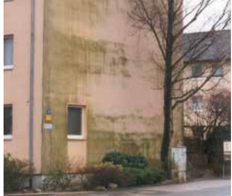
Bild 6.2: Algenbewuchs auf einer Fassade
