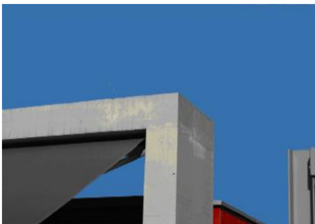
Problème de construction: Eléments en béton, l'eau pénètre dans le béton par le haut, en passant par les rebords.
