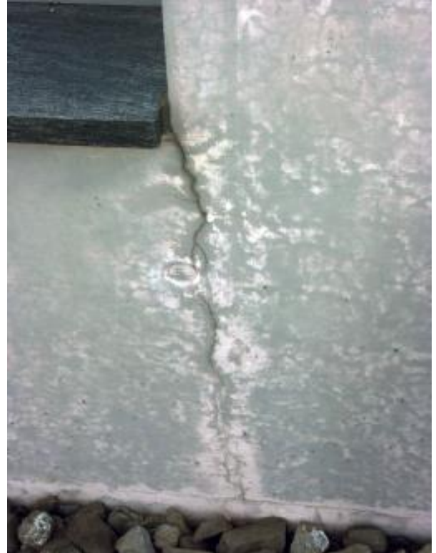
Mur en béton: l'eau pénètre dans le béton par le bas et entre par les flancs des fissures. La couche de peinture a une épaisseur inférieure à 20 \mu\text{m} .
