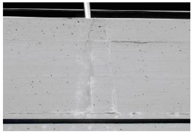
Efflorescences sur des balcons, à partir de fissures et de rebords.
