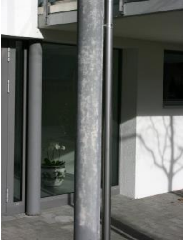
Piliers de béton préfabriqués qui ont été enduits aussitôt après la livraison, sans évaluation du support.
